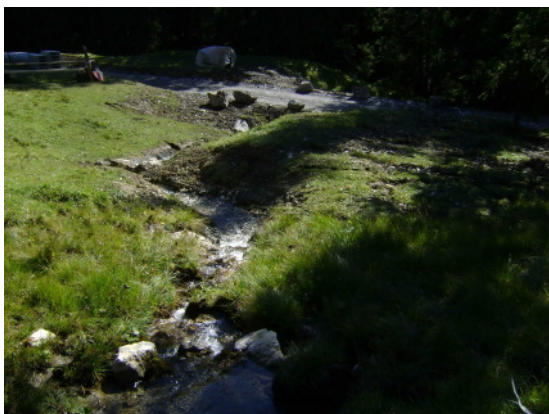
Beim Einbau der Durchlässe wurde speziell darauf geachtet, feuchte Stellen möglichst nicht zu entwässern.
